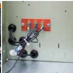
Tablilla de conexiones
