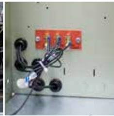
Tablilla de conexiones
